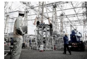
現場管理(変電)
